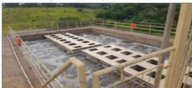
Figura 49 - Tanque de aerção - ETE Samambaia.
