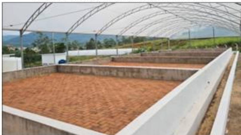
Figura 45 – Leito de secagem do lodo gerado - ETE Horto Florestal.
