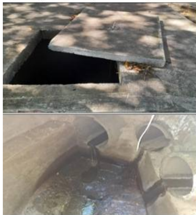
Figura 92 - Caixa de drenagem na Avenida dos Imigrantes.
