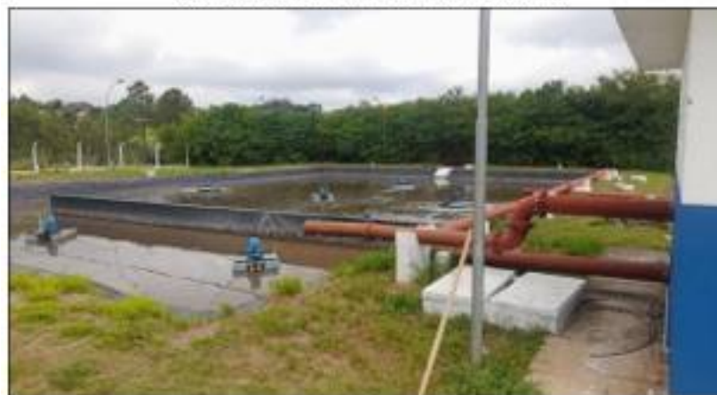
Figura 44 - Lagoa de aeração - ETE Horto Florestal.
