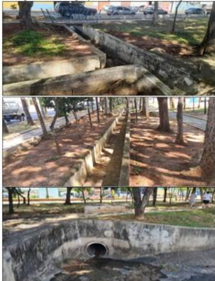
Figura 91 - Galeria de águas pluviais presentes na Avenida dos Imigrantes.
