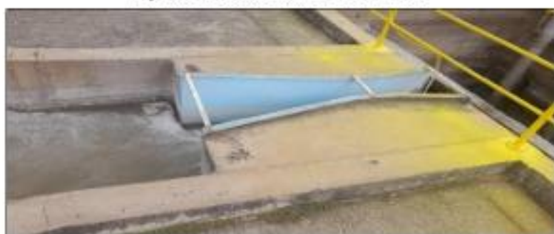
Figura 48 - Medidor de vazão - ETE Samambaia.
