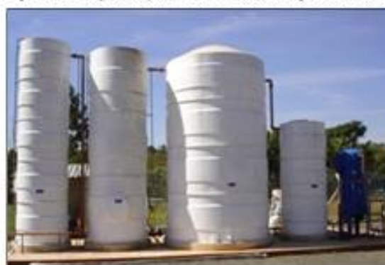
Figura 55 – Estação Compacta de Tratamento de Esgotos Sanitários.
