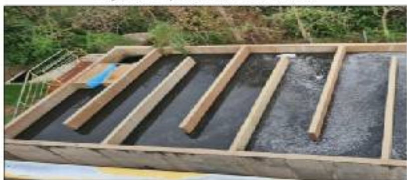
Figura 47 - Tanque de contato - ETE Samambaia.
