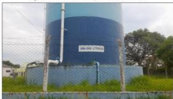
Figura 36 – Reservatório com capacidade de 300 mil litros.
