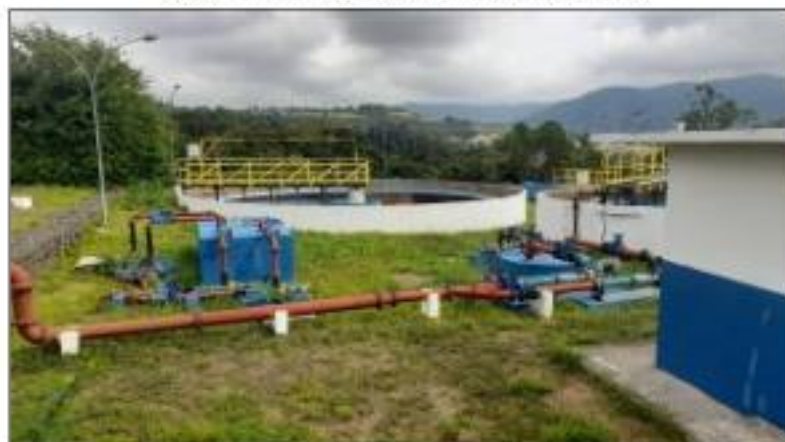
Figura 43 – Interior da ETE Horto Florestal. Coordenadas – Lat: 22°32'43.17"S / Long: 47°53'14.16"O
